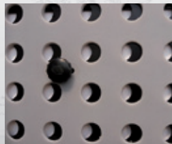
Ventilation grille V1. Grille de ventilation V1
